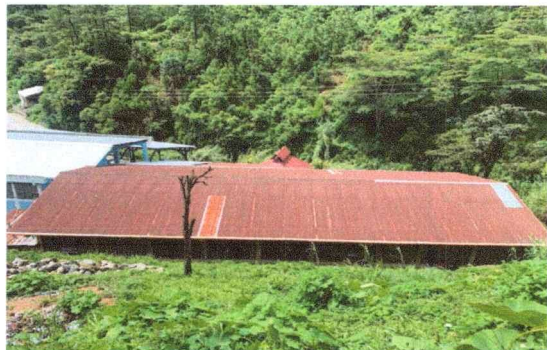
Foto 1: Las láminas de zinc del modulo 1 se encuentran oxidadas en su totalidad que ameritan sustitución.
